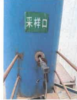
◎2 窑废气排放口 DA002
