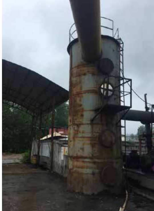
制煤气脱硫塔
