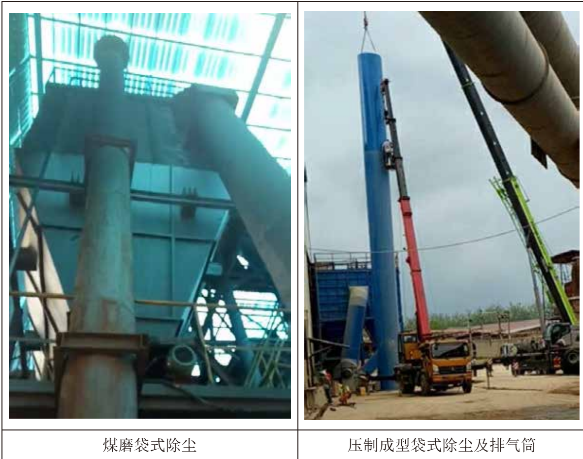
图 4.1-1 项目废气处理设施现场照片
