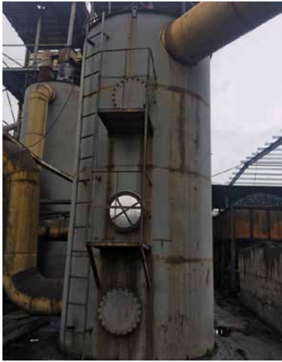
制煤气脱硫塔
